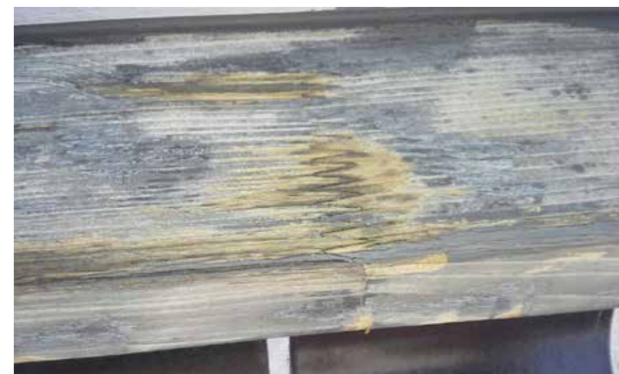
De vingerlasverbinding scheurt los. Dit heeft gevolgen voor het schilderwerk dat mee scheurt.
