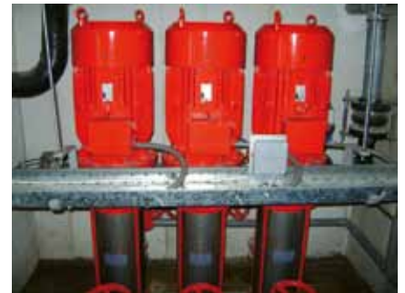
Pompinstallatie VvE City Tower te Zoetermeer
